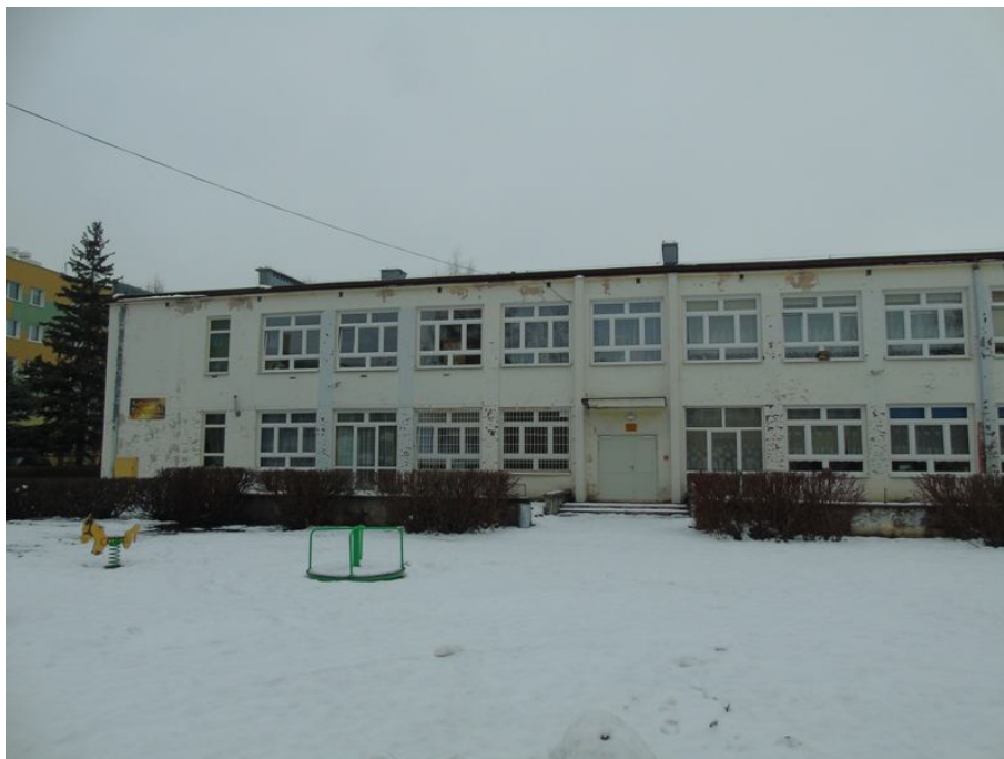
Fot. 5. Ogólny widok elewacji budynku z widocznymi otworami stropodachu.
