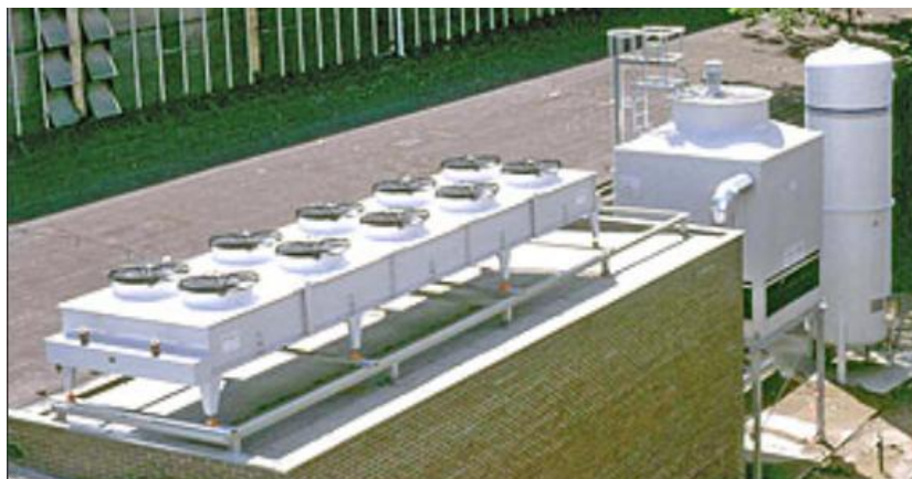
Rysunek 35: Przykład chłodni wentylatorowej zainstalowanej na dachu budynku.
