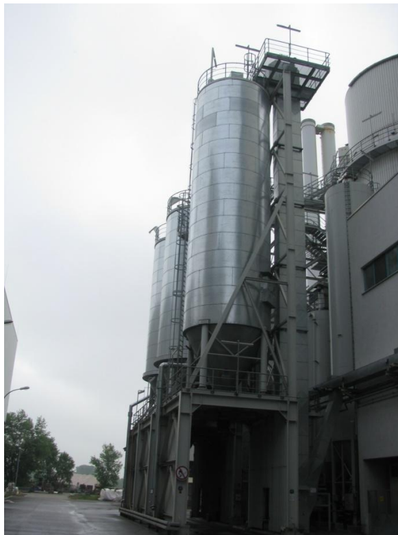
Rysunek 25: Silosy przejazdowe na pozostałości poprocesowe.
